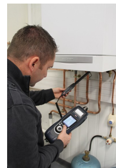
Vérification CO chaudière
